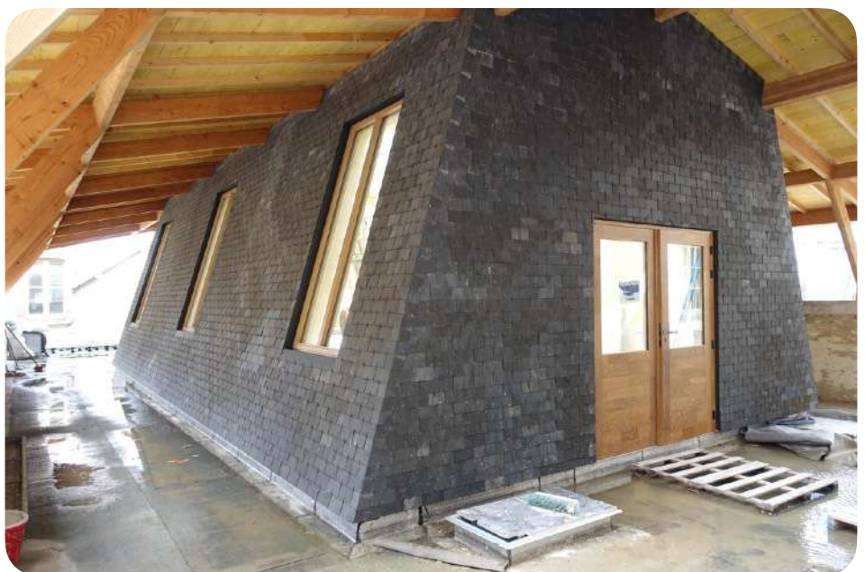
Slates reused as wall covering inside, Hôtel Pasteur (FR) © Encore Heureux architectes
