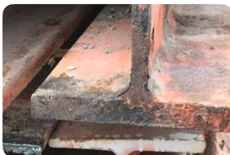
Deterioration of the original coating © Gebruikte bouwmaterialen Weert
