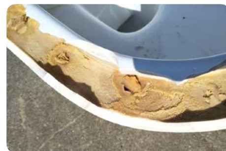
Kalkvorming in de spoelrand en verstopping van de spoelgaten
