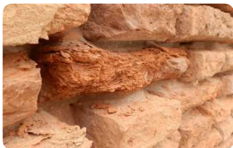
Afbrokkelende baksteen, ongeschikt voor hergebruik
