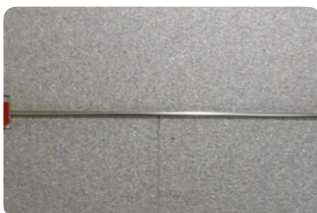
Verdiepte voeg opgevuld met metalen elementen
