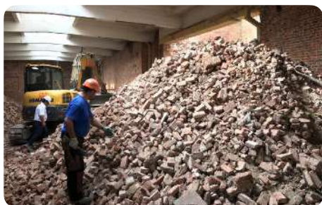
Sloop en hergebruik in situ. Renovatie Loadtoren, Brussel © BVDA - Bernard Van Damme Architecte
