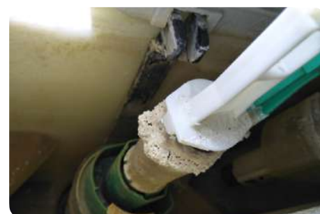
Kalkvorming in de spoelinrichting
