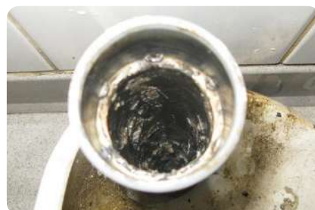
Afvoerelement waarop zich vuil heeft afgezet
