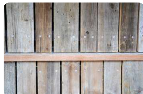
Installatie van 2600 m 2 gevelbekleding van barnwood uit Oost-Europa, Instituut voor Plantkunde van de ULg, Luik (BE). © André Warnier
