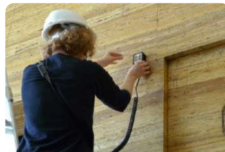
Opsporen van de metalen ankers van een natuursteenbekleding met behulp van een pacometer © WTCB
