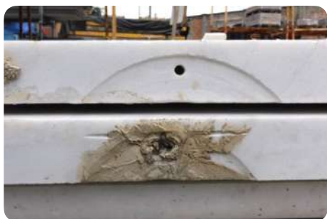
Boven: intact pengat Onder: pengat gevuld met mortel
