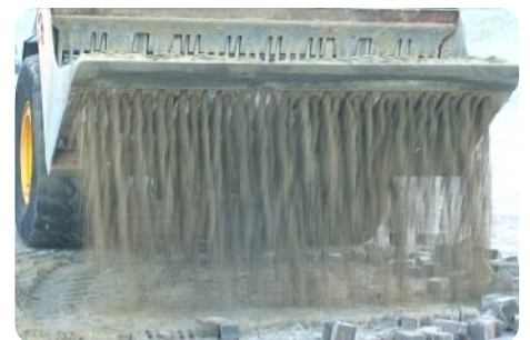
Uitbreken en kuisen van klinkers door middel van een graafmachine met schudbak © VSB Sierbestrating
