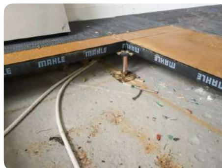
Zelfdragende verhoogde vloer. Houtvezelplaattegels met een textielbekleding (tapijttegels).
