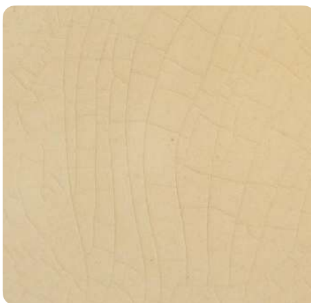
Close-up sur le phénomène de tressillage
