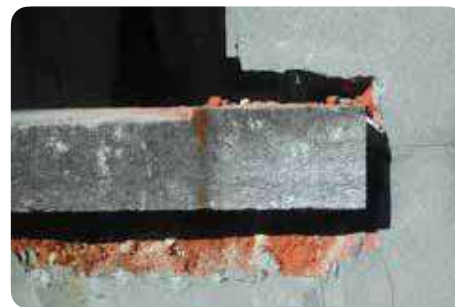
Dégagement du haut, du côté et du bas du seuil © CDR Construction
