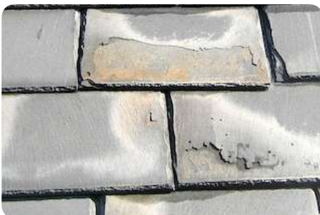
Efflorescences et délamination © nachi.org
