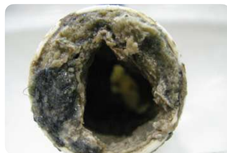
Dispositif d'évacuation encrassée
