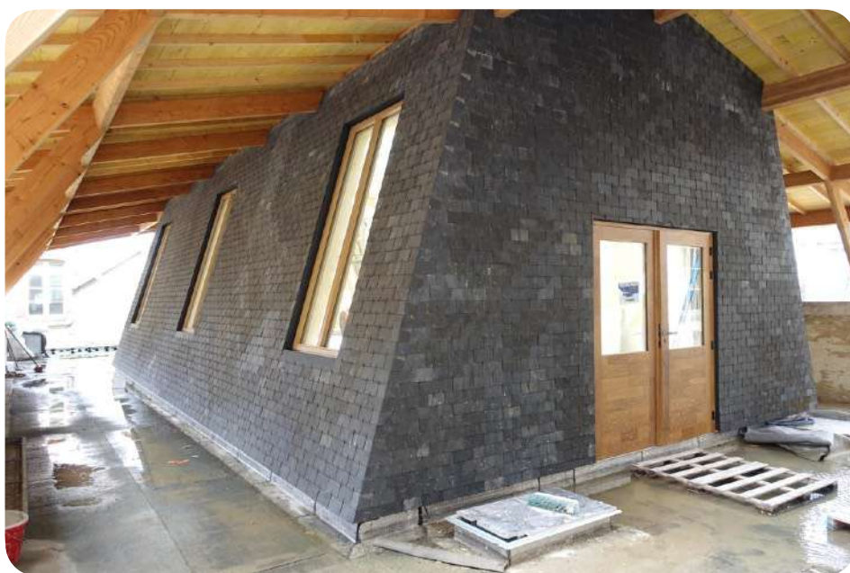
Ardoises réemployées en revêtement mural à l'intérieur, Hôtel Pasteur (FR), © Encore Heureux architectes
