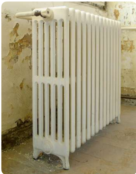
Radiateur à colonne de style « classique »
