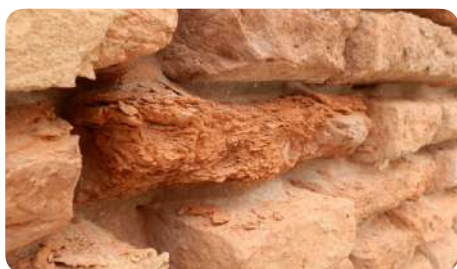
Brique effritée, inapte au réemploi
