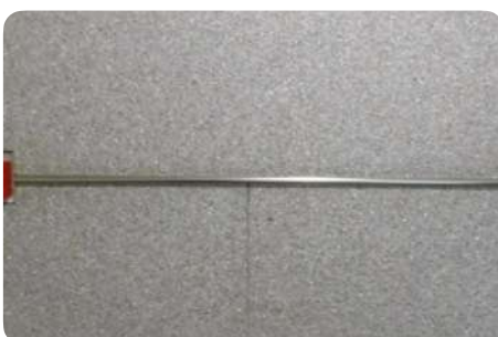
Joint creux comblé par des éléments métalliques
