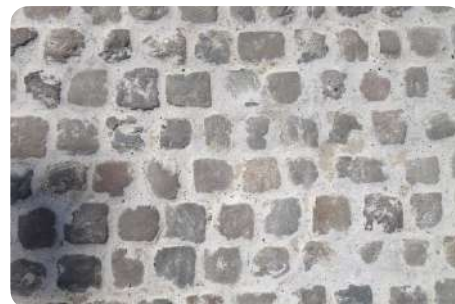
Pavés avec joints ciment : la récupération s'annonce difficile
