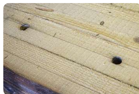
Présence de trous, fissures et dégradations sur les éléments récupérés
