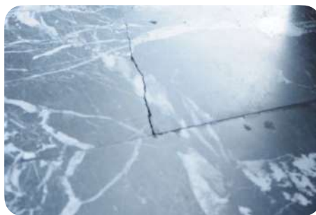
Fissures profonde et éclats
