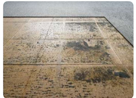
Résidus de colle sur la face supérieure des dalles.
