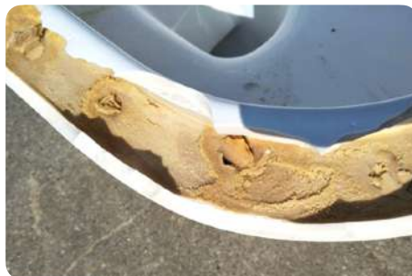
Entartrage de la bride et obstruction des trous des orifices de rinçage
