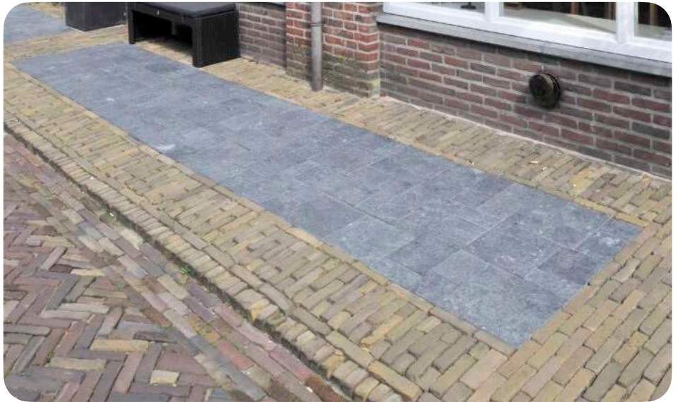
Rénovation de trottoir en pavé de terre cuite de réemploi, Bergen (NL), 2020 © Stone Base
