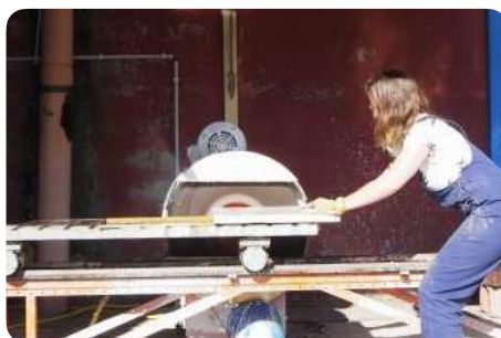
Retrait des résidus de mortier de jointoyage sur la tranche au moyen d'un lapidaire
