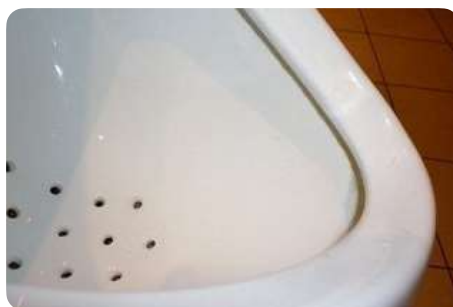
Traces de tartre au niveau de la bride, après nettoyage
