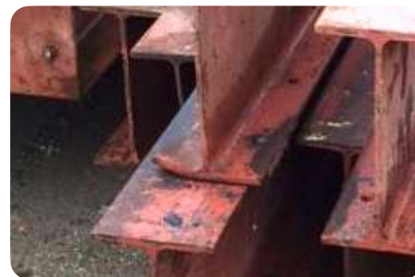
Coins déformés © Gebruikte bouwmaterialen Weert
