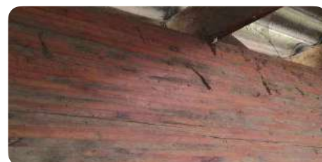
Caractérisation des fissures © SGI
