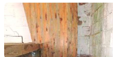
Dégradations dues à une exposition prolongée à l'humidité © SGI
