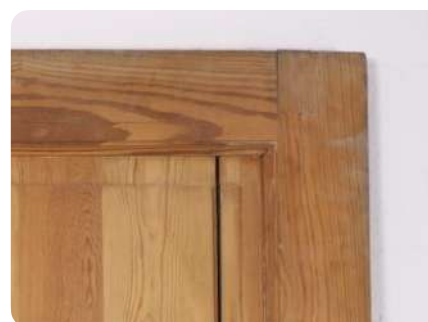
Panneau plein fissuré
