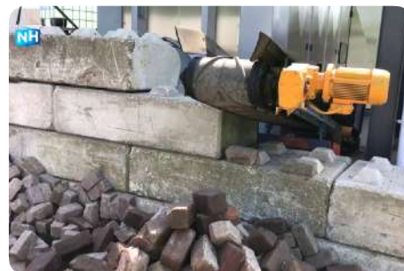
Processus de nettoyage et de conditionnement automatisé de pavés en terre cuite de réemploi. © NH Nieuws, 2018 ( https://www.youtube.com/watch?v=lmeWIMkrwoU )
