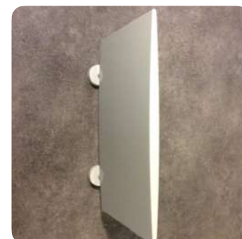
Les installations collectives peuvent être complétées par des séparateurs d'urinoirs, qui se prêtent également bien au réemploi
