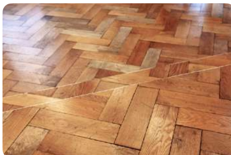
Détails d'assemblage de lots différents. (Haut) MA-MOUT architecten & Atelier d'architecture AUXAU / Maison Renier-Chalon (BE) © Guy-Joël Olivier (Bas) Librebook © ROTOR
