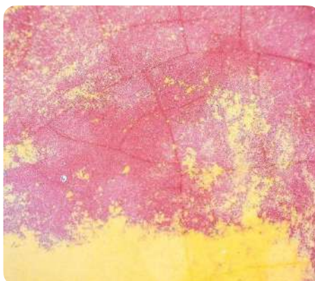
Tressillage des carreaux ciments
