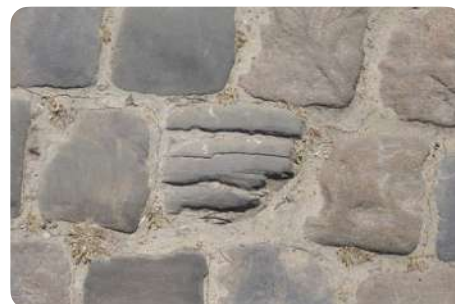
Exemple d'un pavé en grès mal posé. Le plan de clivage doit être parallèle au sens de pose. Dans ce cas-ci, le pavé a probablement subi des contraintes ayant entraîné son clivage. Ce pavé sera écarté au cours du tri lié au réemploi.
