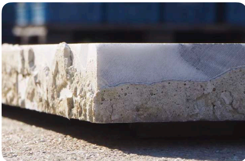
Présence de résidus de mortier
