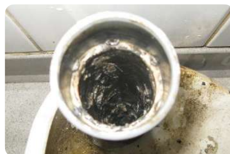
Dispositif d'évacuation partiellement nettoyé
