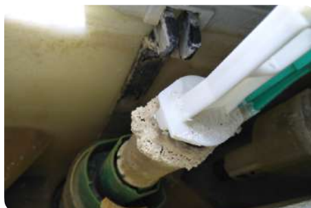
Entartrage du mécanisme de chasse
