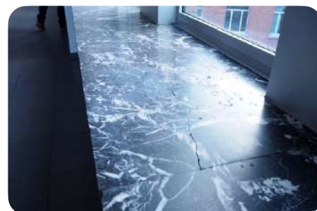
Fissures profonde et éclats
