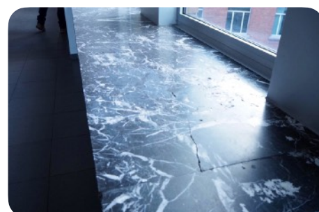
Fissures profonde et éclats
