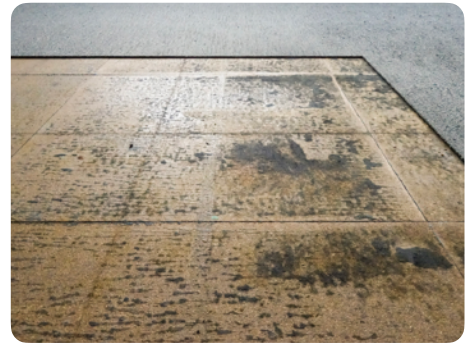
Lijmresten op de bovenzijde van de tegels.
