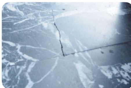
Fissures profonde et éclats
