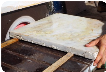
Retrait des résidus de mortier sur la tranche au moyen d'un lapidaire
