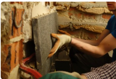
Revêtement en pierre fixée à l'aide d'agrafes métalliques scellées dans des plots au mortier
