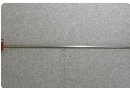
Joint creux comblé par des éléments métalliques
