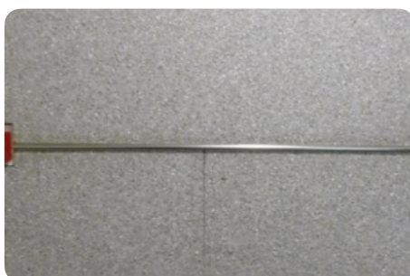
Verdiepte voeg opgevuld met metalen elementen
